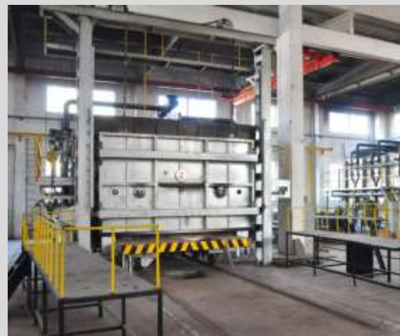
天然气正火炉 2台 Natural Gas Normalizing Furnace 2sets
